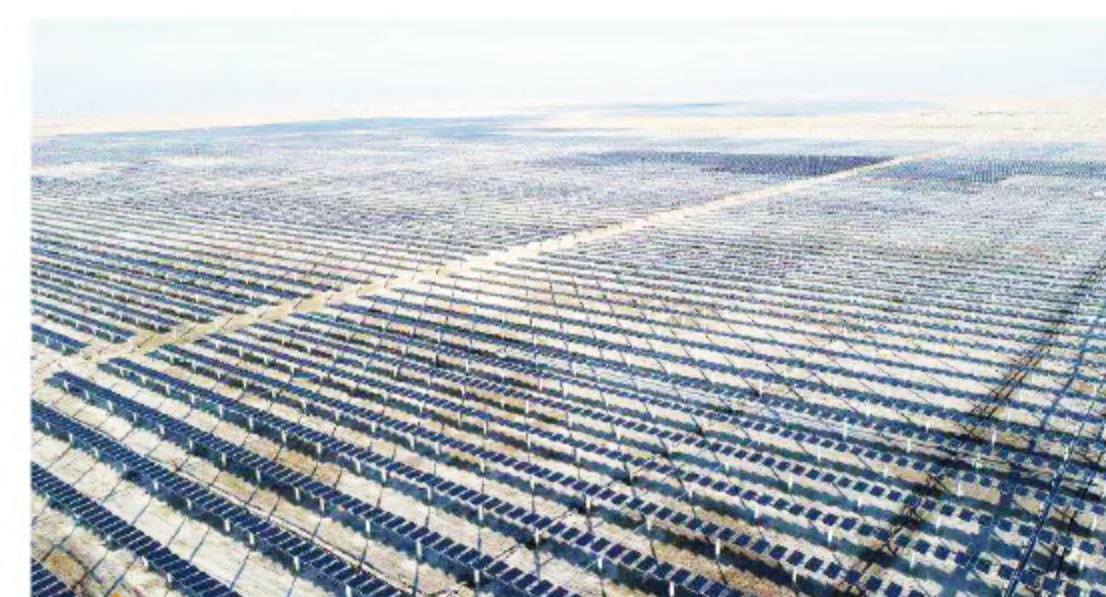
白城光伏跟踪项目 PV tracking project in Baicheng
