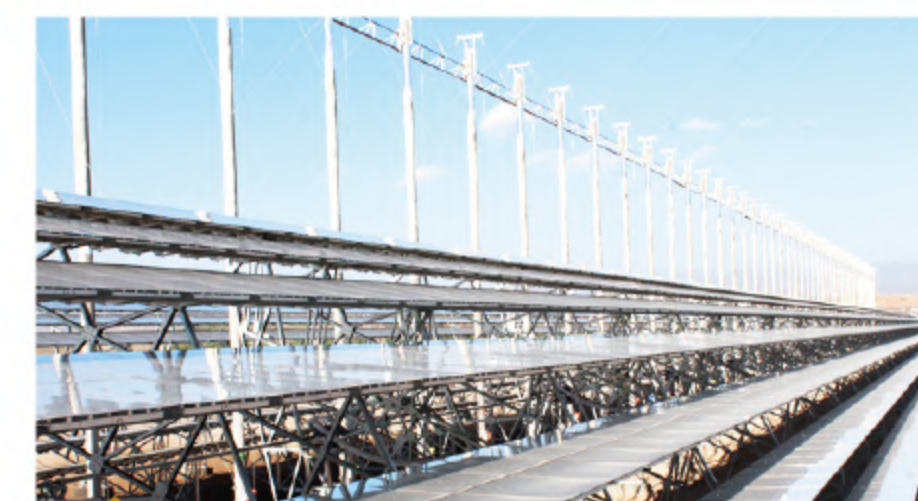
菲涅尔式光热项目 Fresnel Solar Concentrator Project
