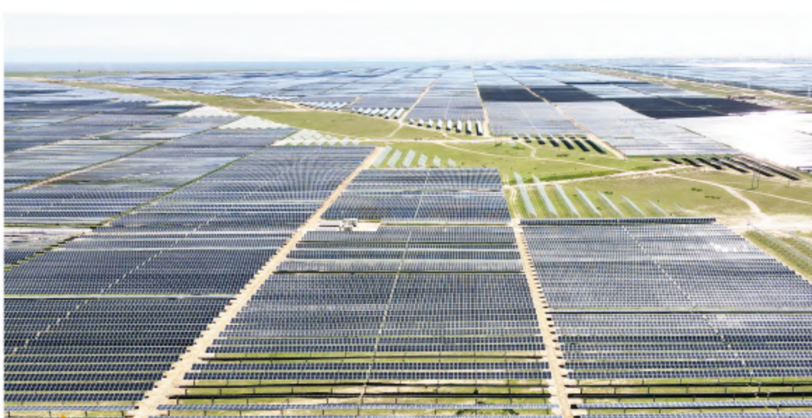
青海光伏跟踪项目 PV tracking project in Qinghai
